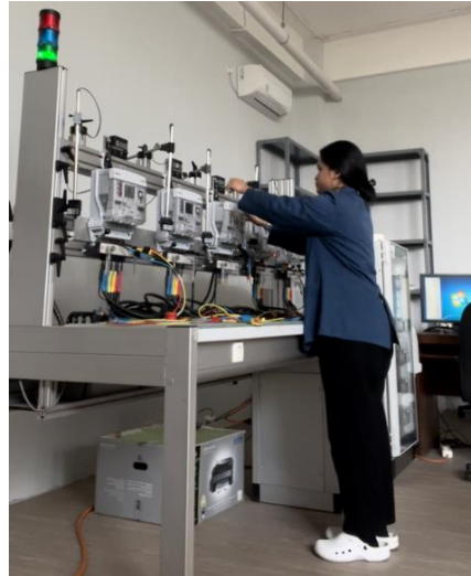
Pengujian di Test Bench Kwh Meter Di UML DKI Jakarta
